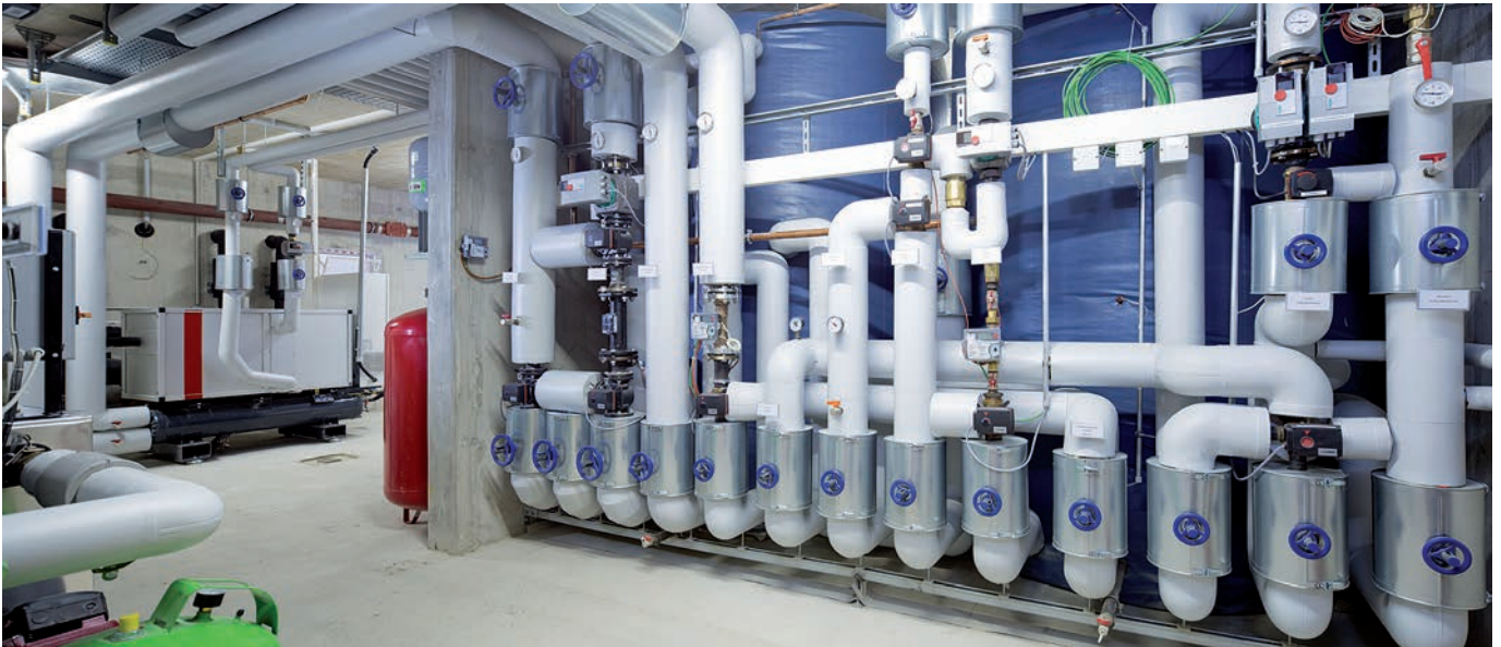
Bild 7. Zentrale Heizung und Warmwasserbereitung
